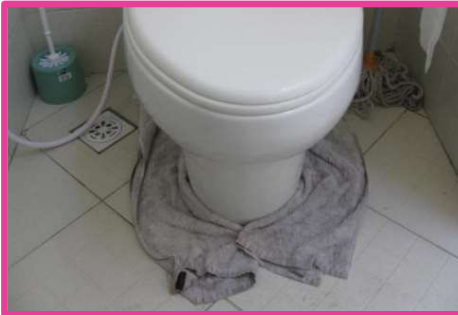
Tömítés szivárgó WC esetében
