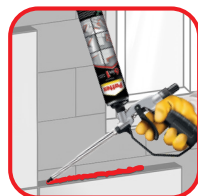
Homlokzati hőszigetelés esetén (EPS, ásványgyapot, parafa stb.)
